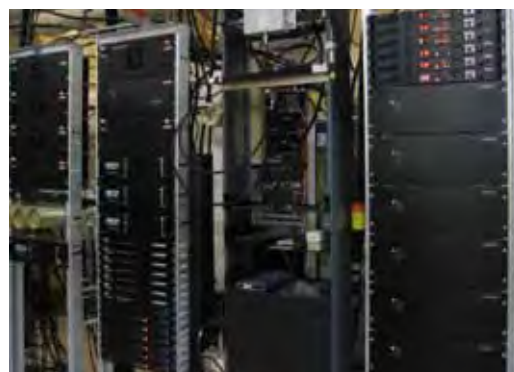
NEXEDGE® システムが導入されている大型ホテルの通信室
