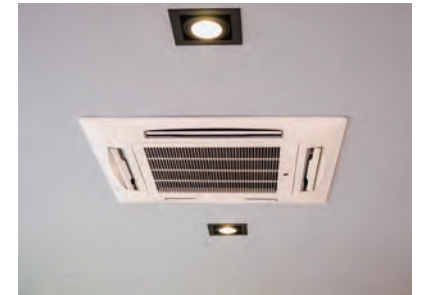
高効率の生産・空調機器への更新
