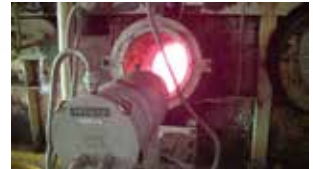
低濃度 PCB 汚染絶縁油処理施設 (1100℃以上で焼却処理)
