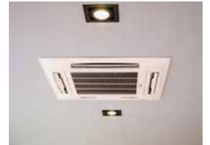
高効率の生産・空調機器への更新
