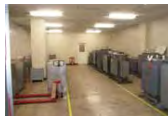
ビクタークリエイティブメディアの PCB 保管室
